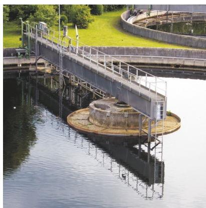
Kläranlagen sind das Haupteinsatzgebiet des Sulfimax GX online WATER
