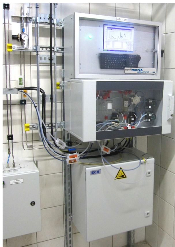
Sulfimax GX online WATER im Einsatz in einem Abwasserdruckleitungsnetz
